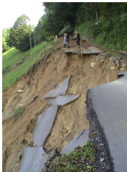
SZ Arth: zerstörte Hofzufahrt
